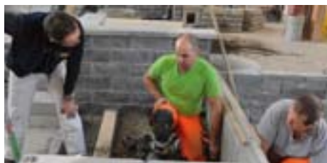
Chefinstruktor Thomas Arpasi erteilt Dominic Jost und Keven Bürcher Anweisungen für das Verlegen der Natursteine.
